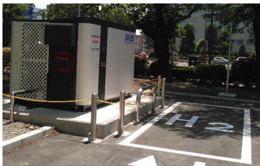
図 14 水素ステーションの設置例
