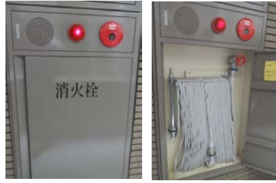
屋内消火栓設備の外観と内部
