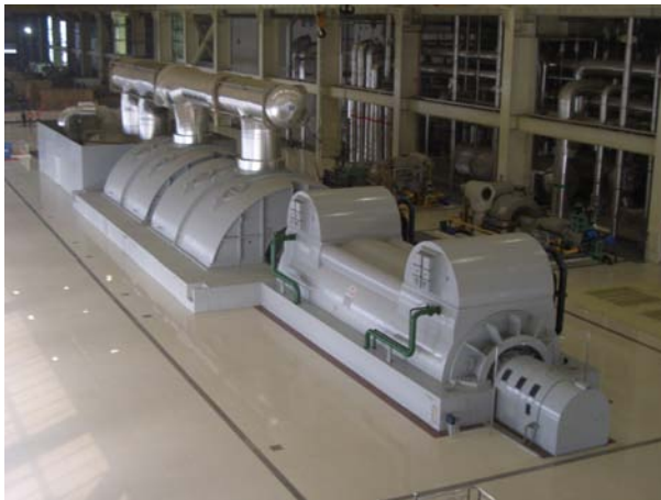
図 18 タービン・発電機 (1,000MW) (画像提供：三菱日立パワーシステムズ株式会社)
