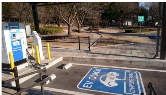
図 13 高速道路の SA に設置された充電ステーション
