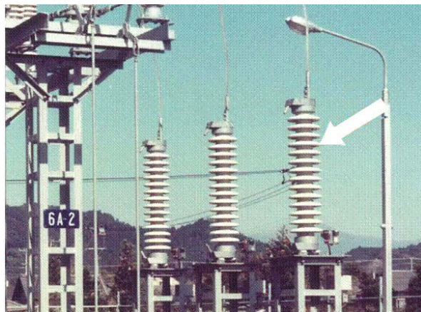
図 45 変電所に設置された避雷器の例 (出典：発明と発見のデジタル博物館 75 )
