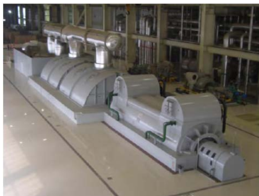
図 39 タービン発電機の例
