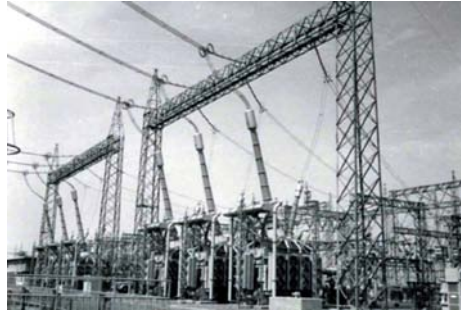
図 25 1973 年に日本で初めて 500kV 送電が始められた時の変電所の写真 (画像提供：東京電力パワーグリッド株式会社)
