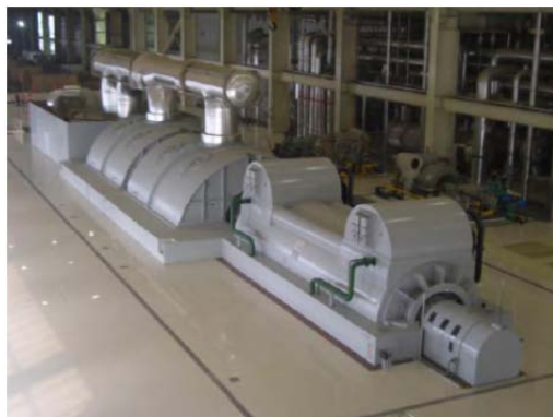
図 39 タービン発電機の例
