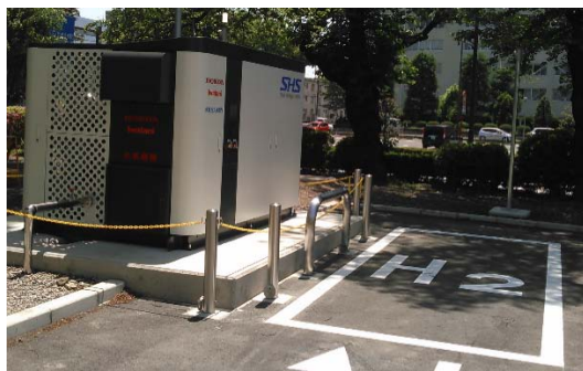
図 14 水素ステーションの設置例
