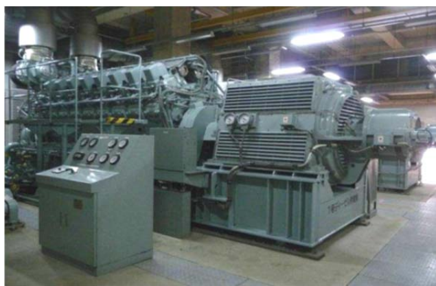
図 41 空港に設置された非常用発電設備の例
