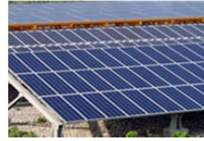
太陽光発電所
